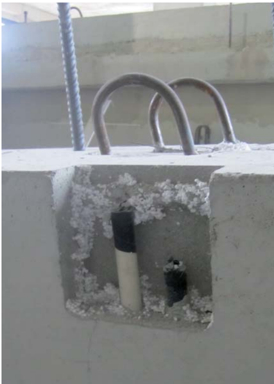
Kuva 35 Polystyreenillä tehty varaus ennen puhdistusta. Sähköputki suojattu teippaamalla. Polystyreenivarauksen voi päällystää liimapintaisella muovikalvolla, jolloin varauksen irroitus ja puhdistaminen on helpompaa.
