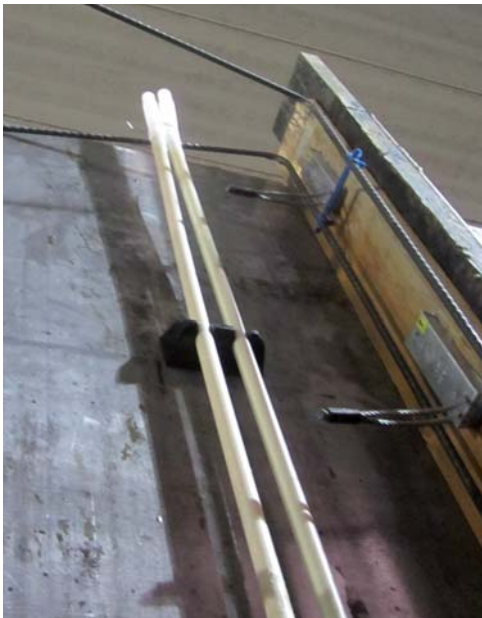
Kuva 31 Kuminen magneetilla kiinnittyvä putkikiinnike.
