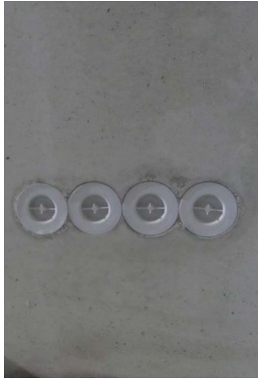
Kuva 34 Neljä kojerasiaa asennettuna.
