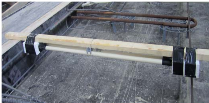
Kuva 19 Päätevaraukset WM2 tehty polystyreenillä. Varausten väliset sähköputket kiinnitetty lautaan rautalangalla ja raudoitekorokkeella.
